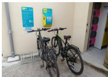
VAE en cours de recharge et effets sécurisés dans les casiers-consignes
